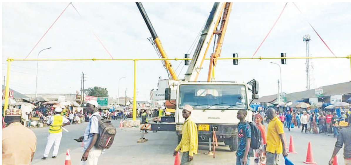
Mkandarasi anayejenga miundombinu ya mabasi ya mwendokasi akifunga taa za kuongozea magari katika barabara ya Kilwa, eneo la Mbagala, Dar es Salaam jana. PICHA: MPIGAPICHA WETU
