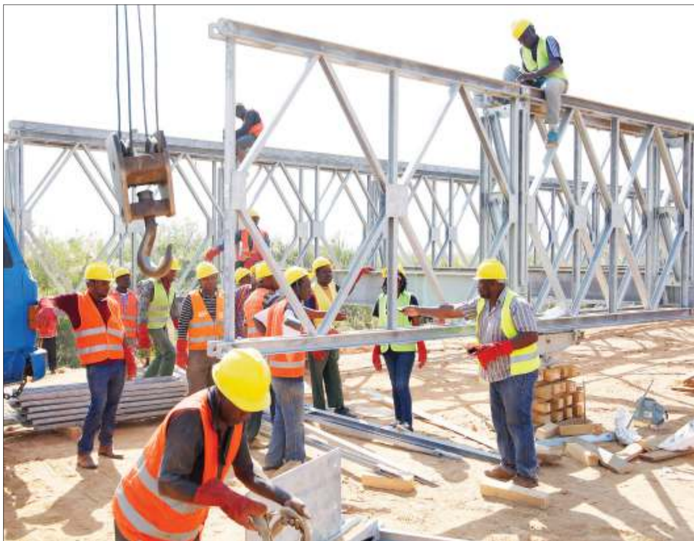
Wahandisi kutoka Wakala wa Barabara za Vijijini na Mijini (Tarura) wakiendelea na ujenzi wa daraja la chuma (Mabey Bridge), lililopo Mto Kihansi, Kata ya Chita Melela katika Halmashauri ya Wilaya ya Kilombero, mkoani Morogoro jana. PICHA: TARURA
