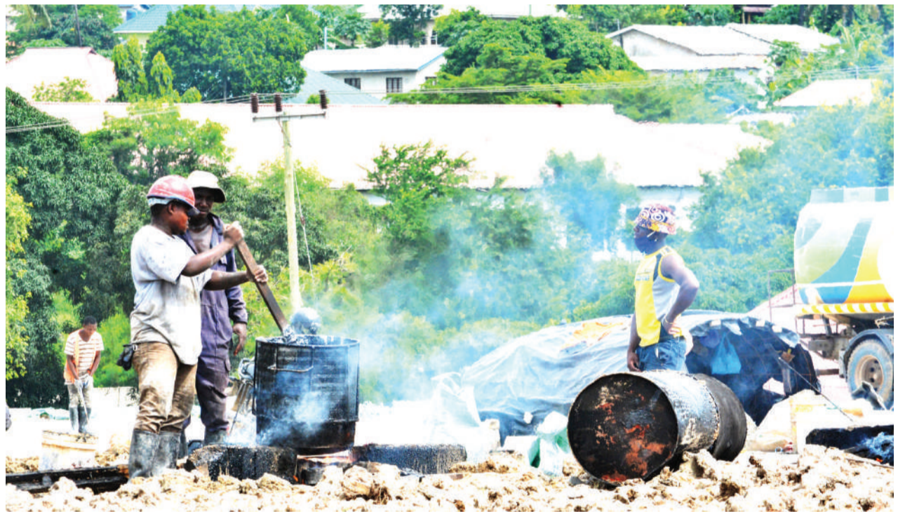
Mafundi wakichemsha lami kwa ajili ya ujenzi unaoendelea wa upanuzi wa Barabara ya Morogoro, eneo la Mbezi Kibanda cha Mkaa, jijini Dar es Salaam jana. PICHA: MIRAJI MSALA
