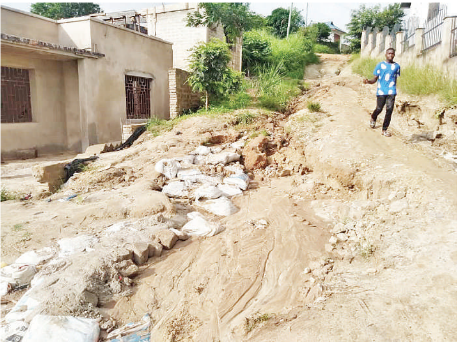
Barabara ya Mtaa wa Kamwela, Goba Matosa, ikiwa imeharibika kutokana na mvua inayoendelea kunyesha jijini Dar es Salaam na kusababisha usumbufu kwa wapita njia na madereva wa vyombo vya moto. PICHA: MPIGAPICHA WETU
