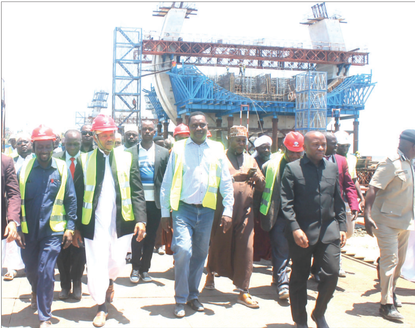
Mkuu wa Mkoa wa Dar es Salaam, Abubakari Kunenge (katikati), akiwa ameongozana na viongozi wa dini, wakikagua ujenzi unaoendelea wa daraja la Tanzanite, litakalounganisha eneo la Upanga Seaview na Oysterbay, jijini Dar es Salaam juzi. Picha: JUMANNE JUMA
