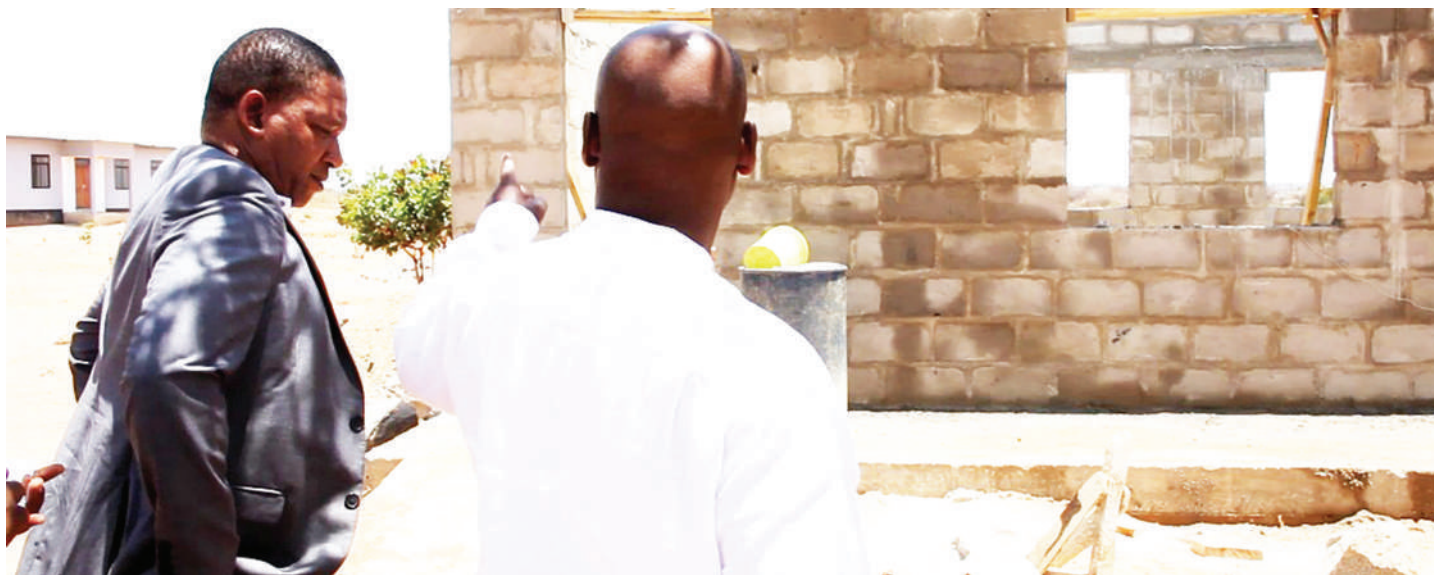
Mkuu wa Mkoa wa Singida, Peter Serukamba (kulia), akitoa maelekezo kwa Mkurugenzi wa Halmashauri ya Wilaya ya Ikungi, Justice Kijazi, alipotembelea jana ujenzi wa vyumba vya madarasa katika shule za sekondari za Ikungi na Unyahati. PICHA: THOBIAS MWANAKATWE
