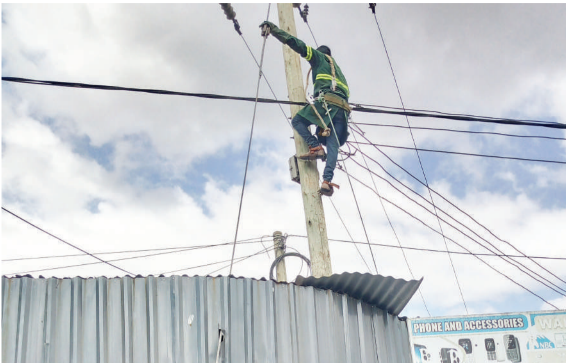
Fundi kutoka Tanesco akirekebisha nyaya za umeme kwenye nguzo ambayo ipo ndani ya viban-da vya biashara eneo la Mbezi Mwisho Dar es Salaam jana. PICHA: SABATO KASIKA
