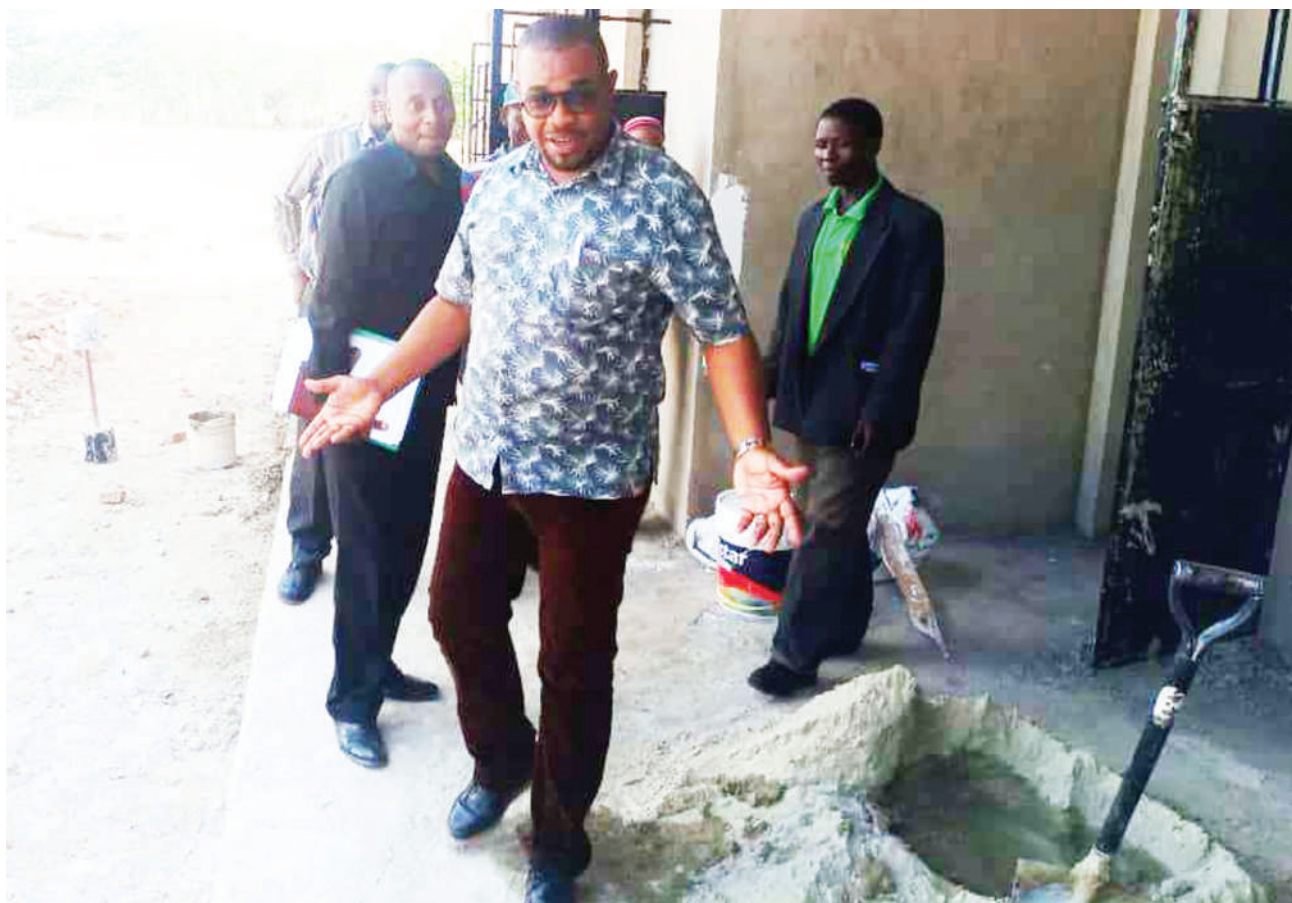
Mkuu wa Wilaya ya Iringa Mjini, Mohamed Moyo, akikagua ujenzi wa madarasa ya sekondari yaliyotumia fedha za UVIKO-19, juzi. PICHA: STEVEN WILLIAM
