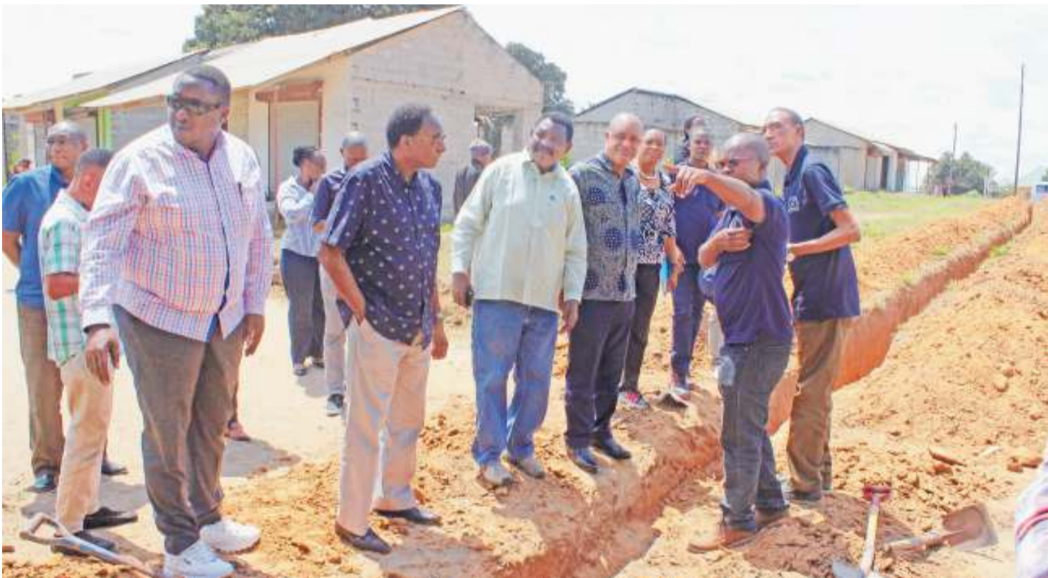
Mwenyekiti wa Bodi ya DAWASA Jenerali Mstaafu Davis Mwamunyange akiwa na baadhi ya Wajumbe wa Bodi walipotembelea mradi wa Maji katika Mji wa Mkuranga unaosimamiwa na DAWASA na kuona shughuli za ulazaji wa mabomba na ujenzi wa tanki la Maji lenye ujazo wa lita Milioni 1.5.
