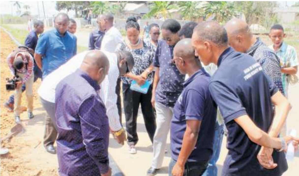
Mwenyekiti wa Bodi ya DAWASA Jenerali Mstaafu Davis Mwamunyange akisikiliza maelezo kutoka kwa baadhi ya wajumbe wa bodi hiyo, walipotembelea mradi wa Maji katika Mji wa Mkuranga unaosimamiwa na DAWASA na kuona shughuli za ulazaji wa mabomba na ujenzi wa tanki la Maji lenye ujazo wa lita Milioni 1.5.
