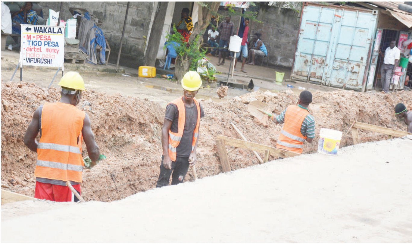
Mafundi wa kampuni ya ujenzi ya Nyanza, wakiendelea na kazi ya kutengeneza mifereji ya maji ya mvua katika Barabara ya Kitunda na Kivule, Manispaa ya Ilala, nje kidogo ya Jiji la Dar es Salaam, jana. PICHA: JUMANNE JUMA.
