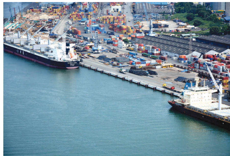
Mradi wa ujenzi na upanuzi wa gati namba 1-7 za Bandari ya Dar es Salaam unaofanywa na kampuni ya China. (Picha/Xinhua)
