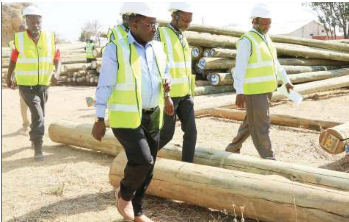
Waziri wa Nishati, Dk. Medard Kalemari (katikati), akikagua nguzo zaidi ya elfu mbili zikiwa zimehifadhiwa katika kituo cha kupoza na kusambaza umeme cha Singida, wakati wa ziara yake ya ukagua ujenzi upanuzi wa kituo hicho, kinachojengwa uwezo wa kupoza na kusambaza umeme wa Kilovolti(kV) 400. PICHA: ZUWENA MSUYA
