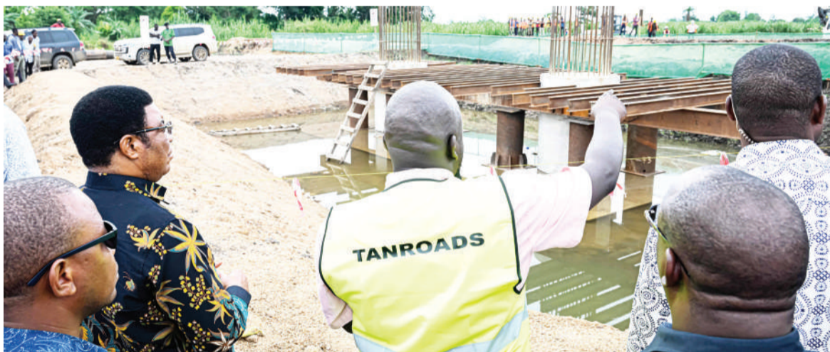
Waziri Mkuu Kassim Majaliwa akikagua miundombinu ya ujenzi wa daraja la Simiyu jana linalunganisha mikoa ya Mwanza, Simiyu na Mara ambalo ujenzi wake utagarimu Sh. bilioni 48.7 hadi kukamilika kwake. PICHA: OFISI YA WAZIRI MKUU
