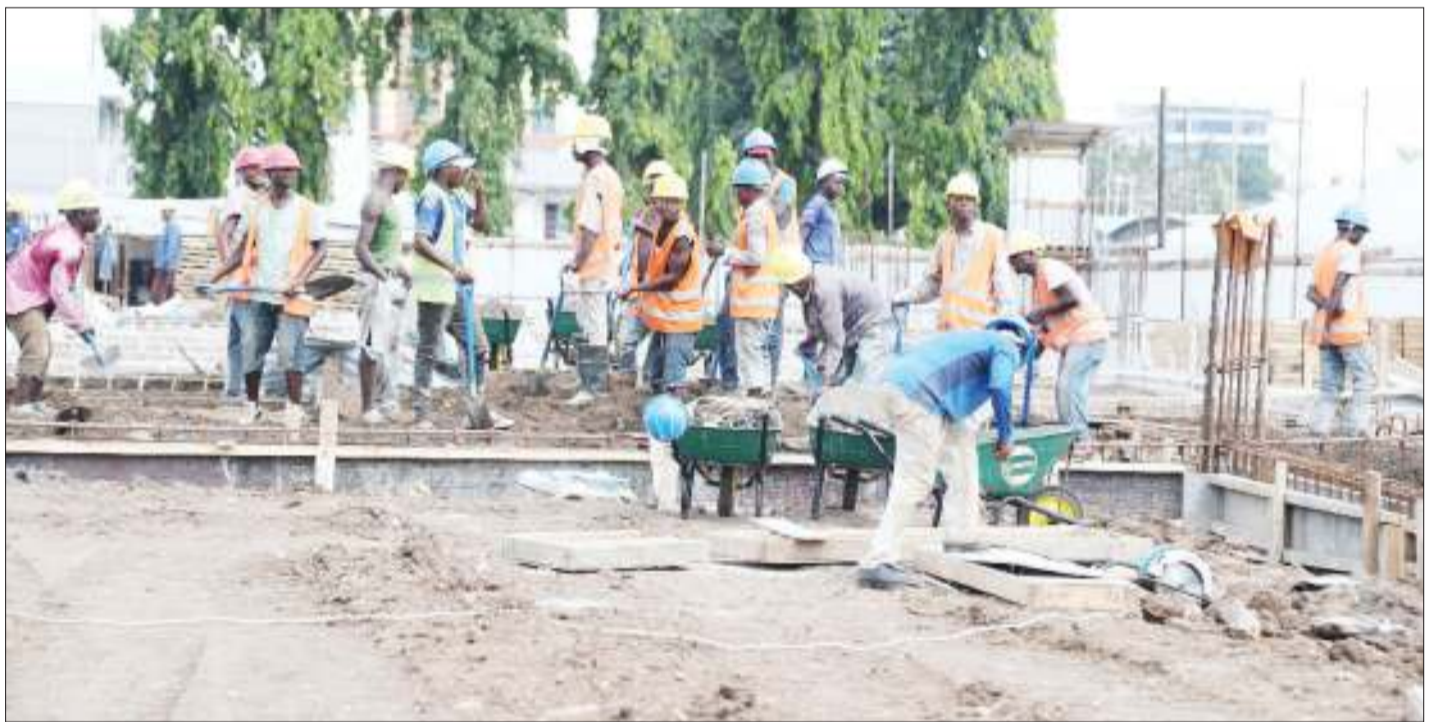
Mafundi wakiendelea na ujenzi wa soko jipya la Magomeni, Manispaa ya Kinondoni, jijini Dar es Salaam jana. PICHA: GETRUDE MPEZYA
