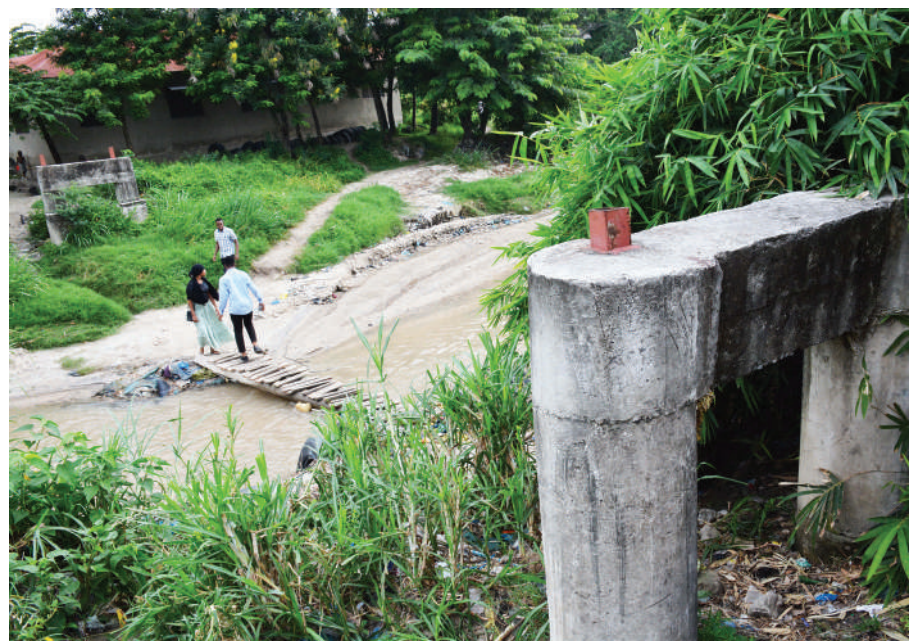
Wakazi wa Mabibo Kisiwani jijini Dar es Salaam, wakipita kwa shida kutoka na na kivuko cha juu kuondolewa na maji, kipindi cha mvua kubwa wanalazimika kuzunguka relini. PICHA: MIRAJI MSALA
