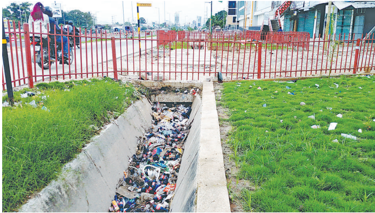
Takataka zilizosombwa na maji ya mvua zikiwa ndani ya mtaro, Mwenge, Manispaa ya Kinondoni, Dar es Salaam jana, kutokana na utupaji holela wa taka katika eneo hilo, ambalo ni maarufu kwa shughuli za wafanya-biashara wadogo 'machinga'. PICHA: SABATO KASIKA
