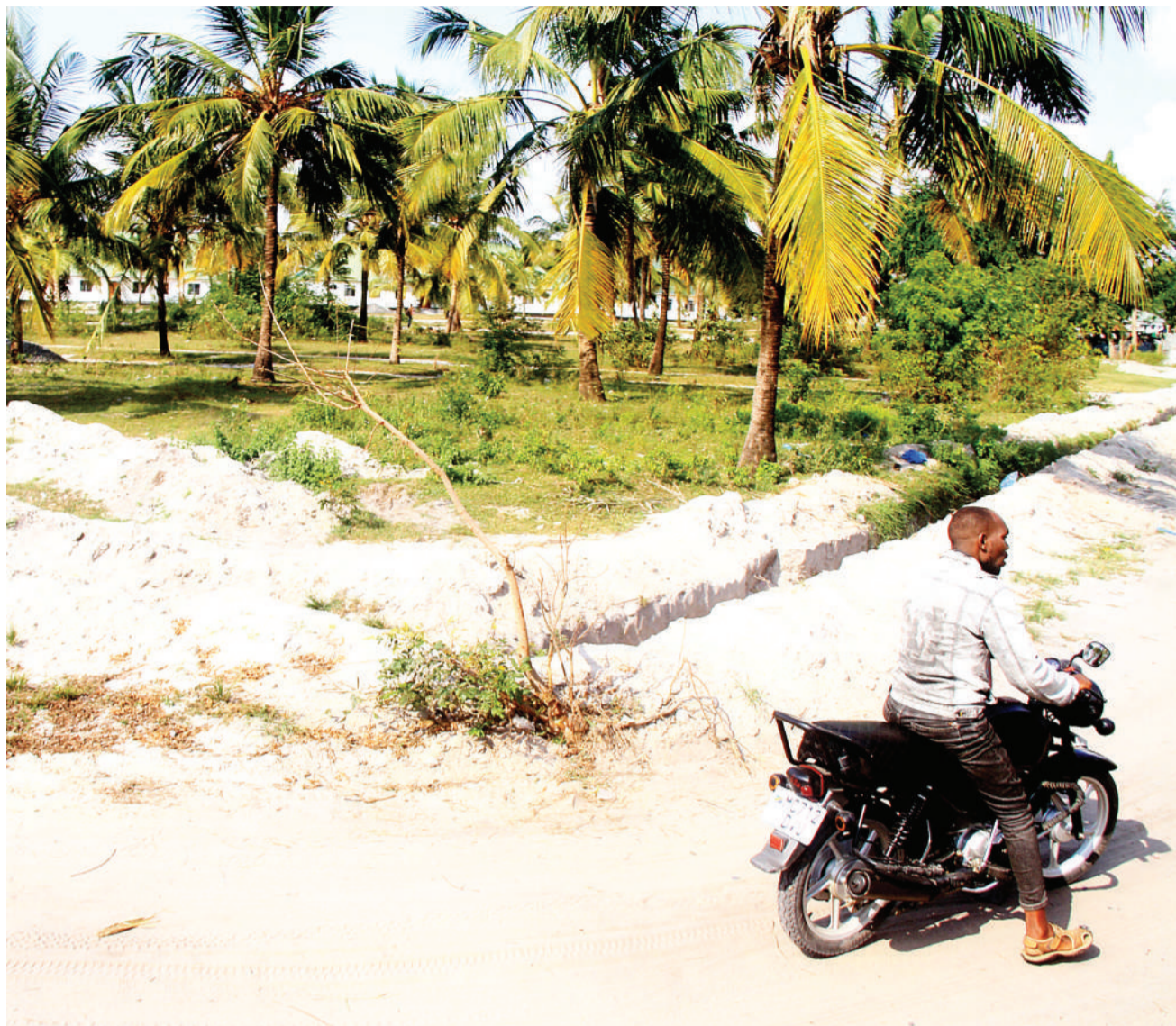
Mashimo yaliyochimbwa katika eneo la Hospitali ya Wilaya ya Kivule jijini Dar es Salaam kwa ajili ya kujenga Uzio wa eneo hilo yakiwa yameachwa kwa muda mrefu bila kujengwa na kuleta usumbufu kwa wananchi. PICHA: JUMANNE JUMA
