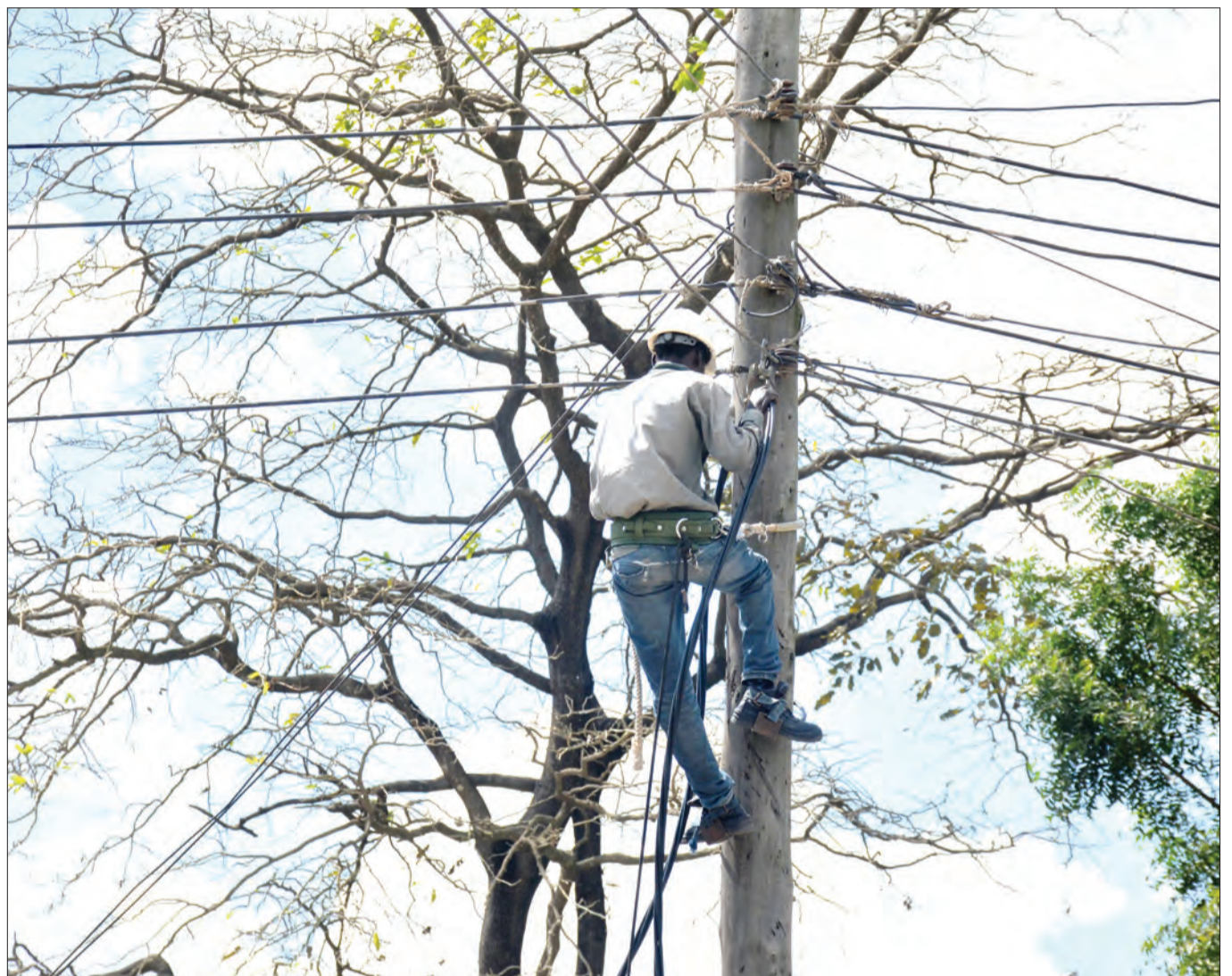
Fundi wa Shirika la Umeme nchini (Tanesco), akifanya marekebisho ya waya baada ya kutokea hitilafu kwenye nguzo katika eneo la Kitunda, jijini Dar es Salaam wikiendi. PICHA: JUMANNE JUMA
