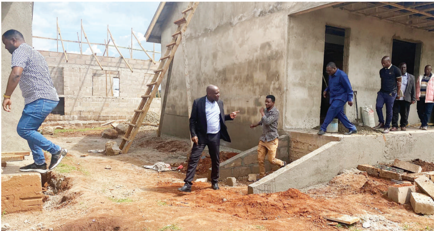
Mkuu wa Wilaya ya Mkalama mkoani Singida, Moses Machali, (aliyevaa koti jeusi na shati jeupe) akiwa na Kaimu Mkurugenzi Mtendaji wa Halmashauri ya Wilaya ya Mkalama, Said Kalima, wakifanya ukaguzi wa ujenzi wa shule ya sekondari ya Kidarafa inayojengwa kata ya Mwanga wilayani humo. PICHA: THOBIA MWANAKATWE
