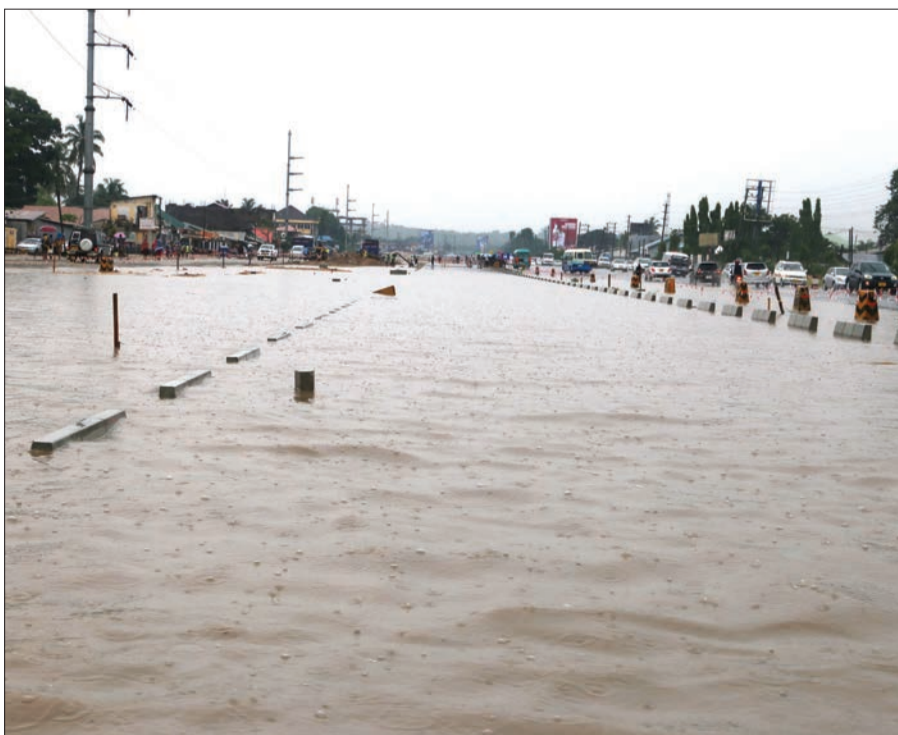
Sehemu ya ujenzi wa upanuzi wa barabara mpya ya Bagamoyo eneo la Bamaga likiwa limejaa maji ya mvua.
