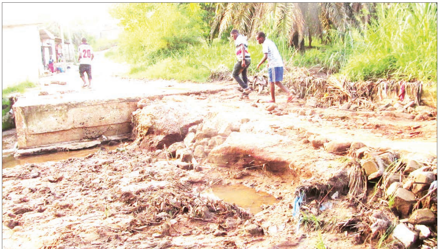
Wananchi wakipita katika barabara iliyoharibika kutokana na mvua inayoendelea kunyesha, katika eneo la Mbezi Makabe, jijini Dar es Salaam, jana. PICHA: SABATO KASIKA
