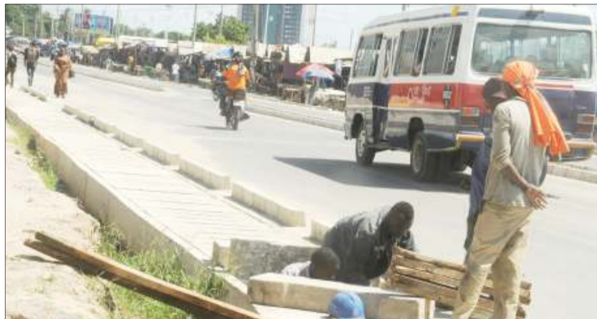
Mafundi wa kampuni ya Ukandarasi, wakiendelea na kazi ya ujenzi wa miundombinu katika Barabara ya Kituo cha Daladala cha Simu 2000, eneo la Ubungo, jijini Dar es Salaam jana. Picha: JOHN BADI
