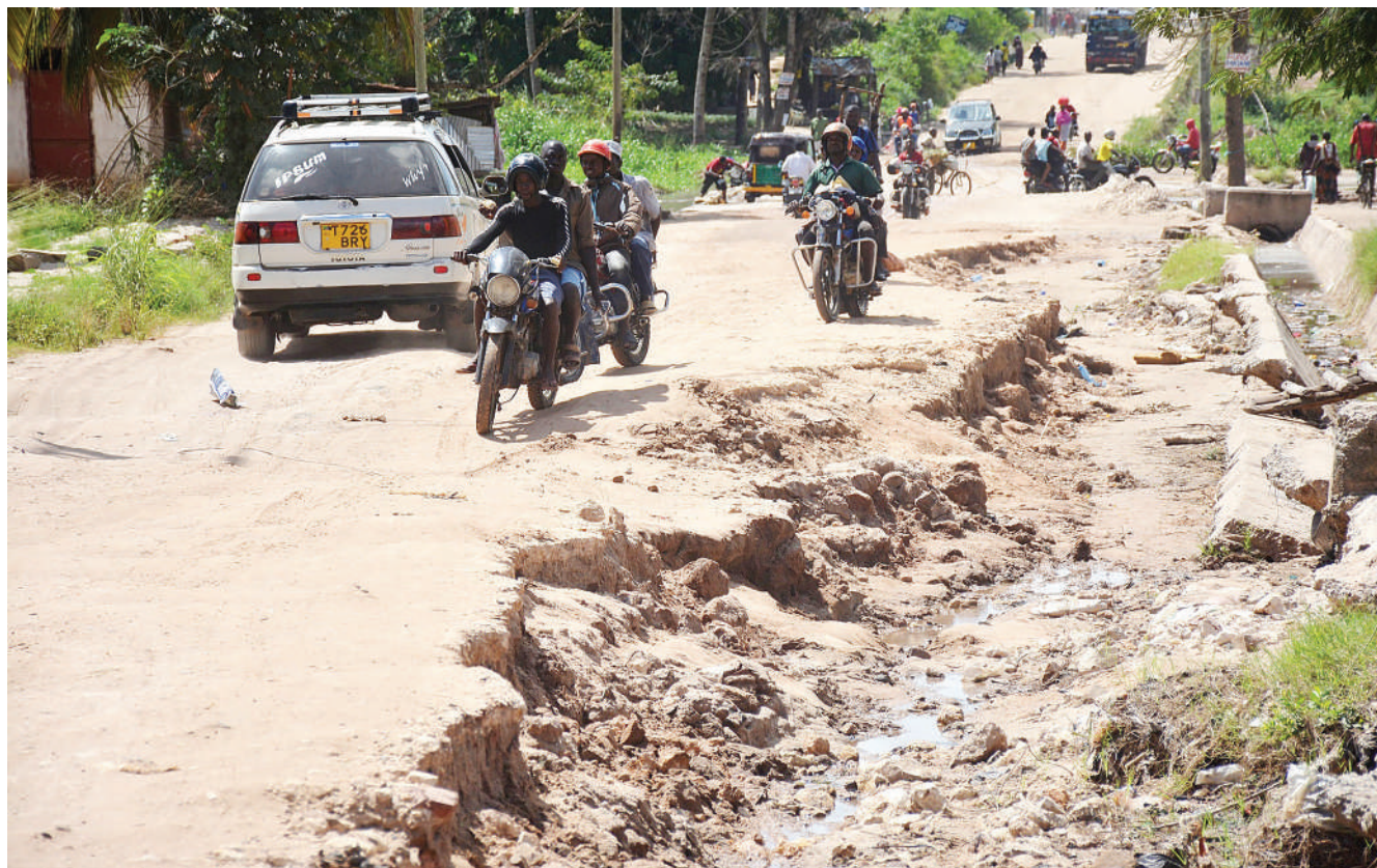
Eneo la barabara ya vumbi likiwa limeharibika vibaya Kitunda kwenda Magole jijini Dar es Salaam kutokana na mvua inayoendelea kunyesha. Picha: JUMANNE JUMA
