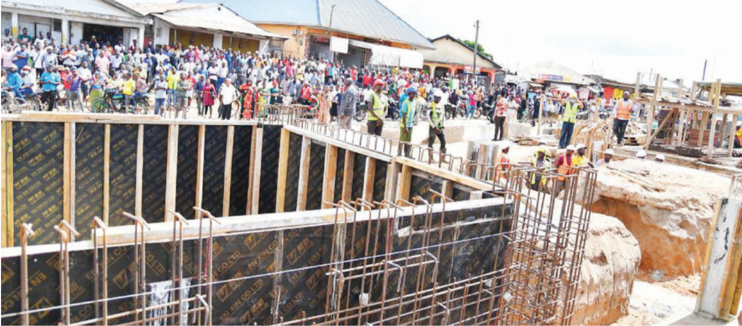
Wananchi wa Mtongani na Kwa Azizi Ali, Dar es Salaam, walipomsikiliza Rais Samia Suluhu Hassan, wakati akikagua ujenzi wa Mradi wa Mwendokasi, katika barabara ya Kilwa. PICHA ZOTE: MTANDAO
