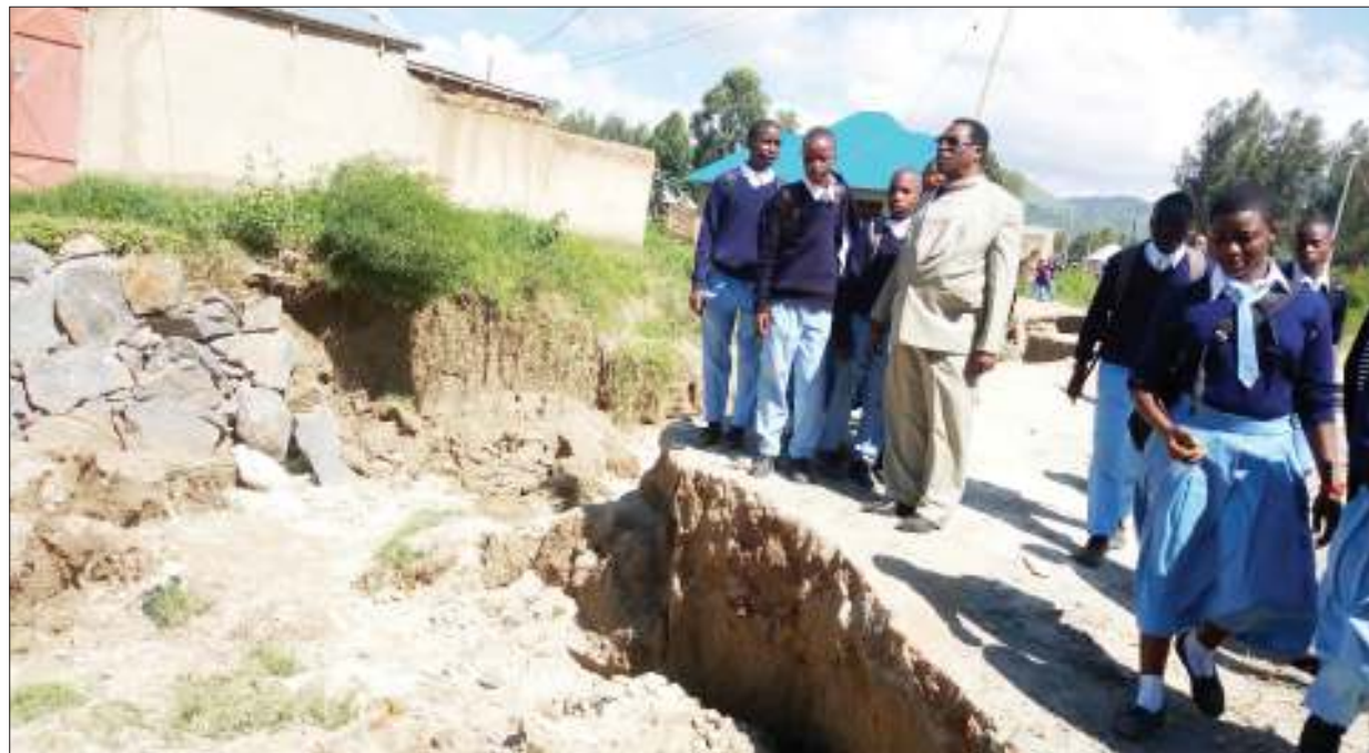
Mkuu wa Wilaya ya Mbeya, William Ntinika (mwenye suti), akiwa na wanafunzi wa Shule ya Sekondari Ilomba mwishoni mwa wiki, akiangalia eneo la barabara ya Ilomba ambayo ilikuwa imeharibika vibaya kutokana na mvua zilizonyesha kabla ya Tarura kuifanyia marekebisha. PICHA: NEBART MSOKWA
