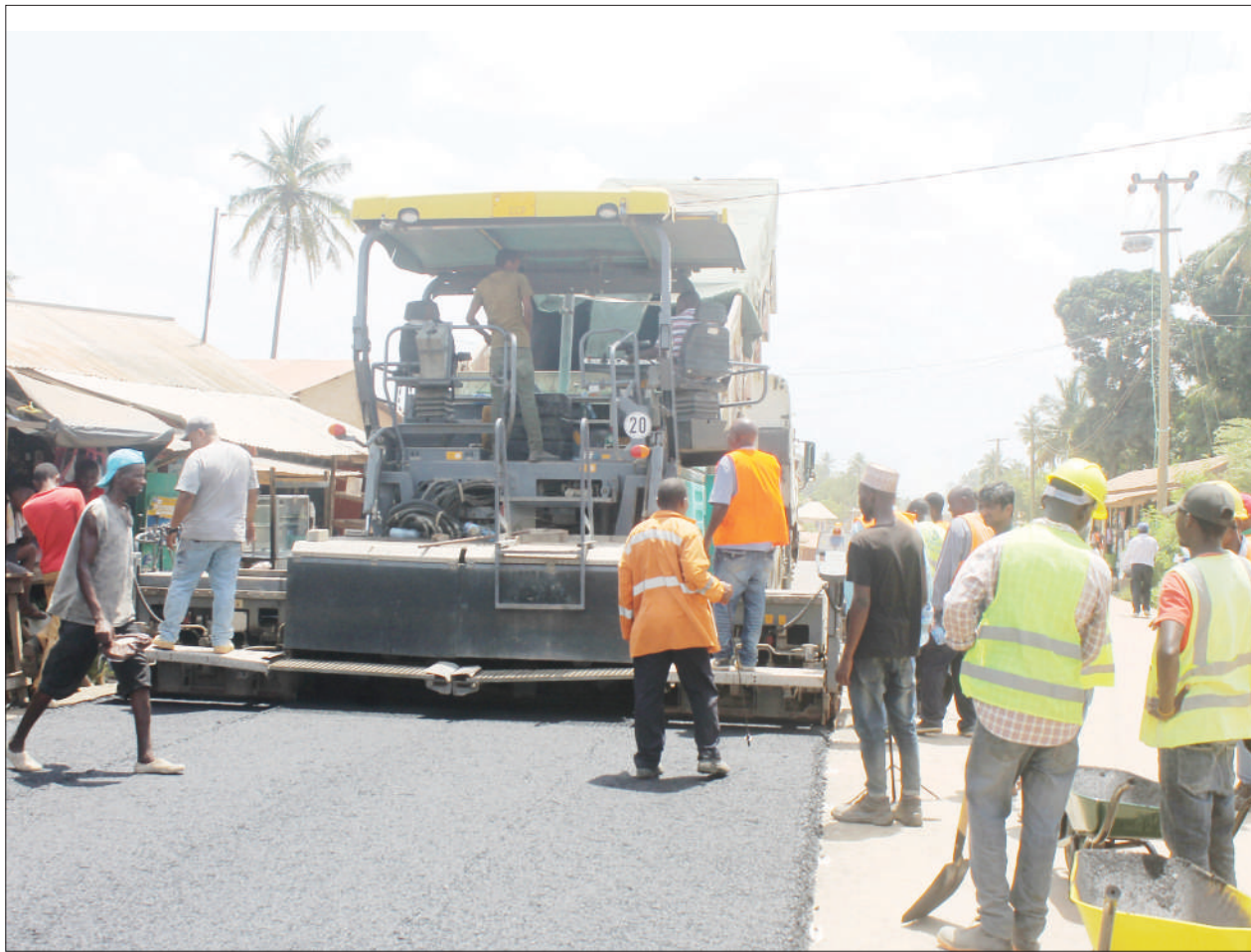
Wafanyakazi wa kampuni ya Nyanza Road, wakiendelea na ujenzi wa barabara ya Kitunda hadi Kivule kwa kiwango cha lami, jijini Dar es Salaam jana. PICHA: JUMANNE JUMA
