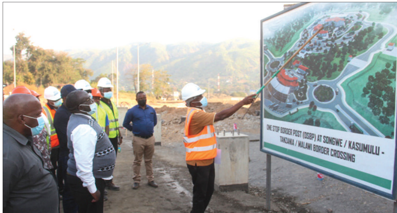
Naibu Waziri wa Ujenzi na Uchukuzi, Mhandisi Godfrey Kasekenya (wa pili kushoto), akipata maelezo kutoka kwa Mwakilishi wa Wakala wa Majengo (TBA), Mhandisi Daniel Mandari, kuhusu ramani ya Kituo cha Pamoja cha Forodha kinachojengwa kwenye mpaka wa Tanzania na Malawi, eneo la Kasumulu, wilayani Kyela, mkoani Mbeya mwishoni mwa wiki. PICHA: NEBART MSOKWA
