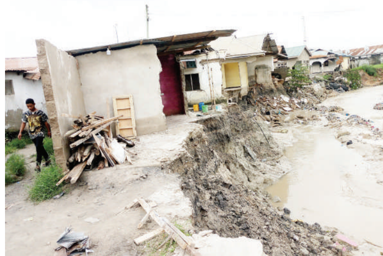
Baadhi ya nyumba zilizojengwa kando ya mto eneo la Mabibo zikiwa zimebomoka kutokana na mvua inayoendelea kunyesha maeneo mbalimbali ya Jiji la Dar es Salaam.
