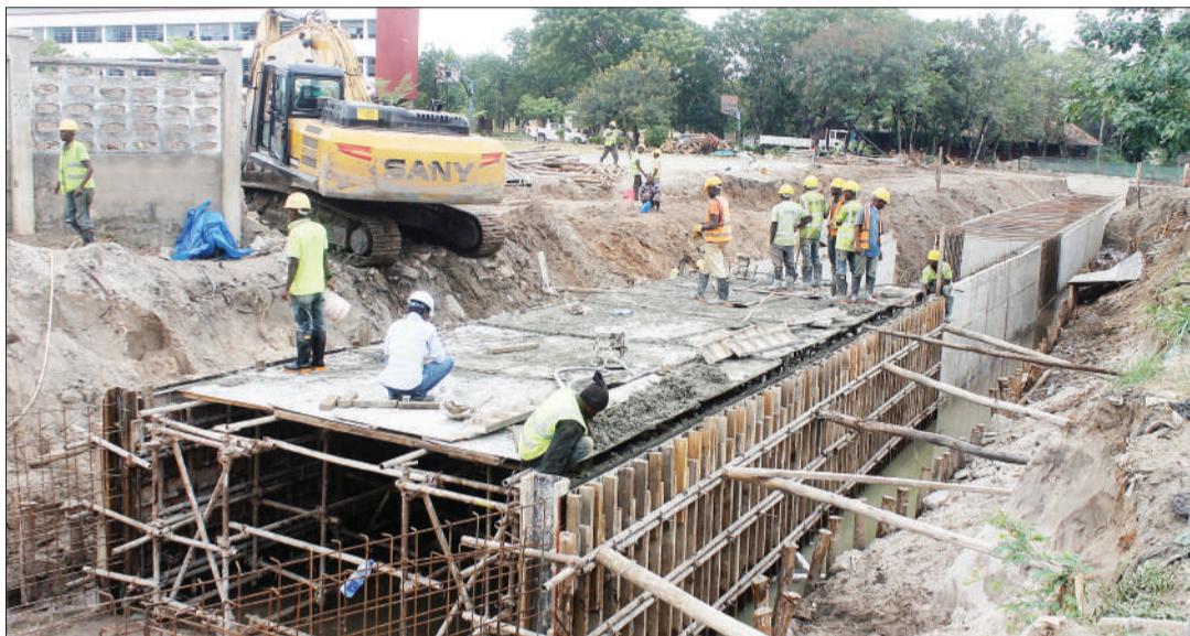
Mafundi wa kampuni ya China Railway Group, wakiendelea na ujenzi wa mfereji wa maji ya mvua katika eneo la Chang'ombe Kibasila, Manispaa ya Temeke, jijini Dar es Salaam jana. PICHA: JUMANNE JUMA.
