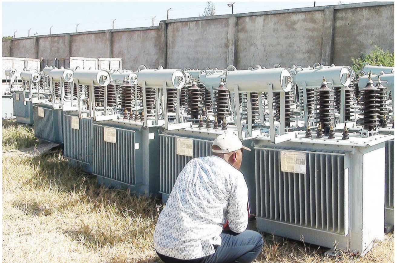
Mjumbe wa Bodi ya Wakala wa Nishati Vijijini (REA), Henry Mwimbe, akikagua transfoma zilizopo kwa ajili ya kusambazwa kwenye vijiji vya eneo la mradi wa usambazaji nishati ya umeme unaotekelezwa na Kampuni ya CCE Co Ltd, mradi huo ulikaguliwa katika vijiji vya Wembere na Ntwike Wilaya ya Iramba, mkoani Singida jana. PICHA: JUMBE ISMAILLY
