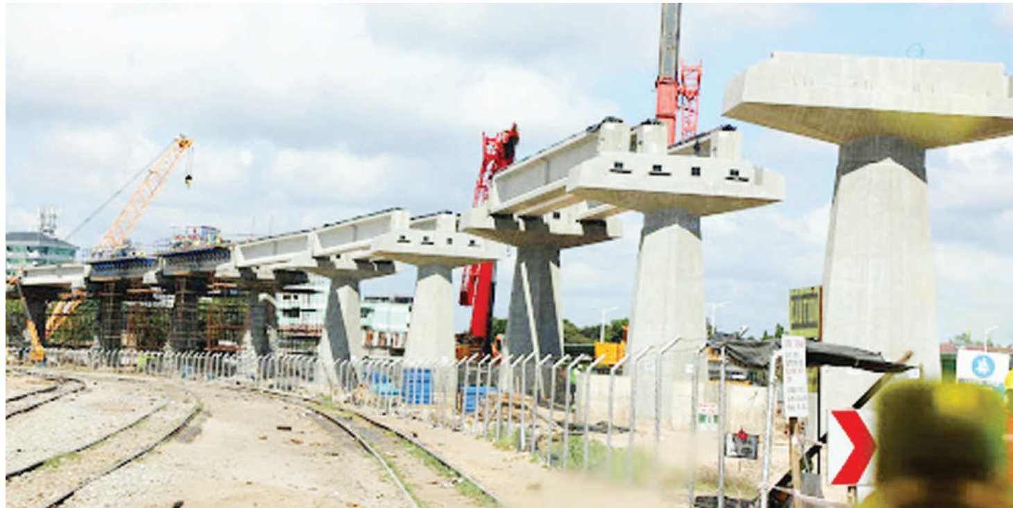
Ujenzi wa reli ya kisasa (SGR) unaoendelea kukamilika jijini Dar es Salaam. PICHA: MTANDAO
