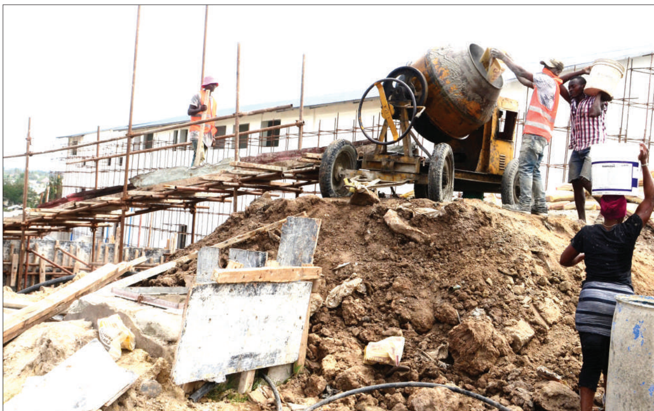
Vibarua wakichanganya zege kwa ajili ya ujenzi unaoendelea wa uzio wa eneo la machinjio mpya ya Vingunguti, jijini Dar es Salaam jana. PICHA: JUMANNE JUMA
