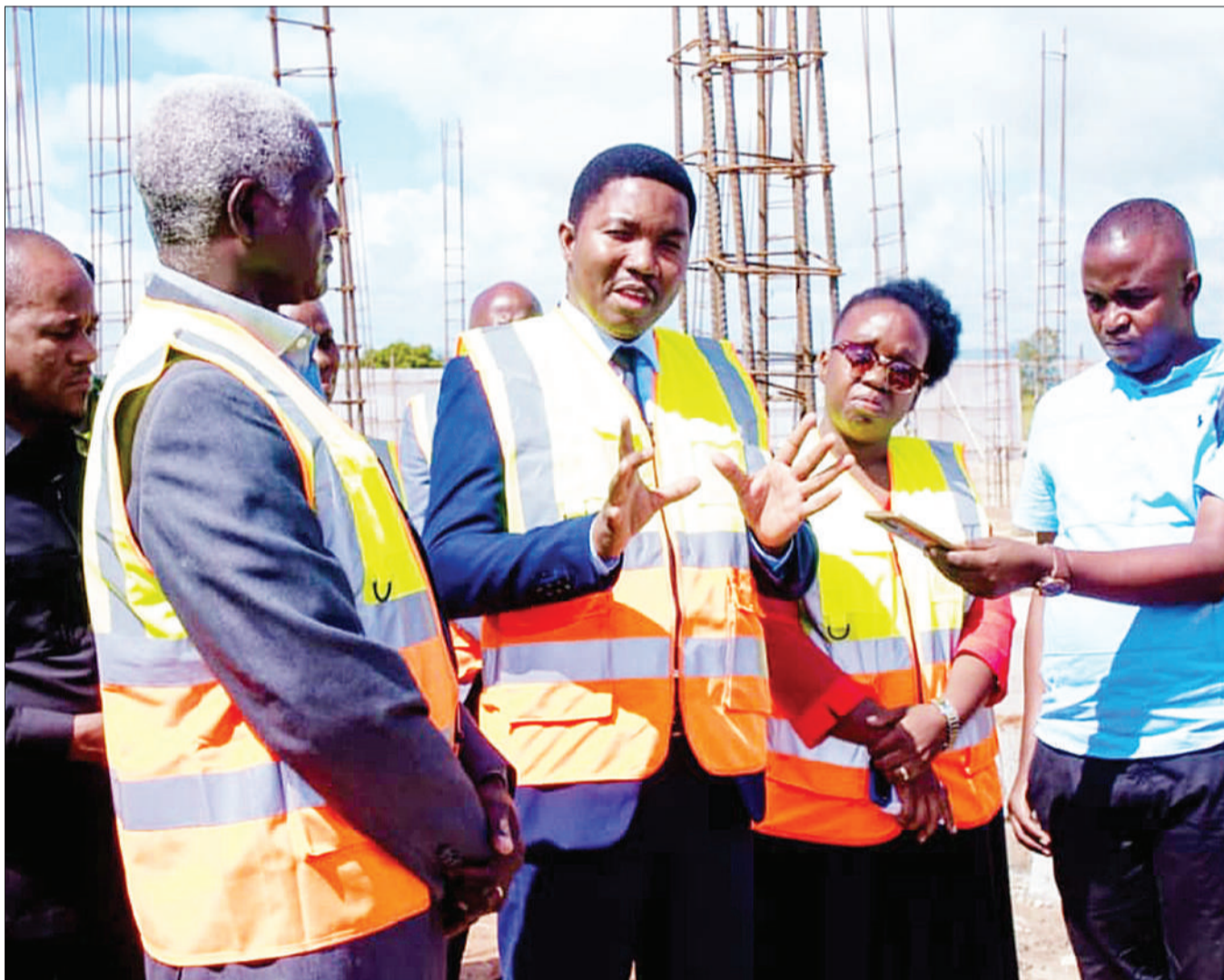
Waziri wa Nchi, Ofisi ya Rais, Tawala za Mikoa na Serikali za Mitaa (Tamisemi), Selemani Jafo (katikati), akitoa maelekezo kwa viongozi wa Mkoa wa Dodoma, alipotembelea kukagua ujenzi wa Hospitali ya Uhuru inayojengwa Wilaya ya Chamwino jana. Wa (pili kushoto) ni Mkuu wa Mkoa wa Dodoma, Dk. Binilith Mahenge. Picha: MPIGAPICHA WETU
