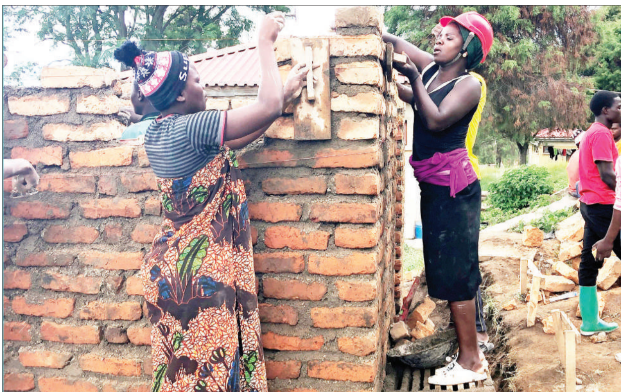
Baadhi ya wanawake wakiendelea na shughuli za ujenzi wa vyoo katika Shule ya Msingi Chalangwa, iliyoko Halmashauri ya Wilaya ya Chunya, mkoani Mbeya, ikiwa ni sehemu ya kujiingizia kipato cha kujikimu kimaisha. Picha: GRACE MWAKALINGA
