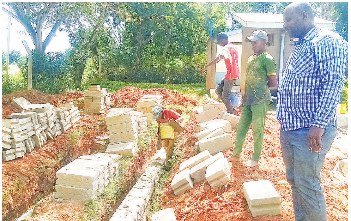
Mkuu wa Shule ya Sekondari ya Kwamkabara, wilayani Muheza, Mkoa wa Tanga, Juma Hango (kulia), akikagua ujenzi wa choo cha matundu nane kwa ajili ya wanafunzi shuleni hapo juzi. PICHA: STEVEN WILLIAM
