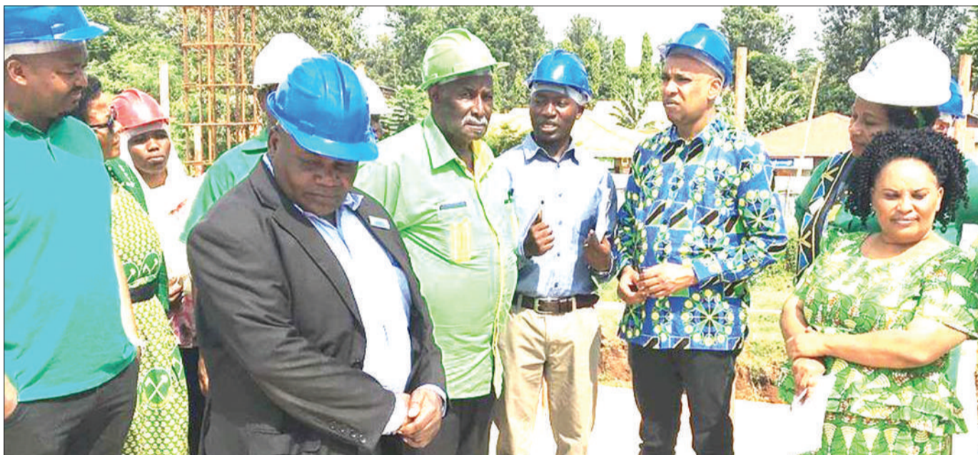
Mkurugenzi wa Manispaa ya Moshi, Michael Mwandezi (aliyevaa koti), akiwa na viongozi wa Kamati ya Siasa ya CCM ya Wilaya na Mkoa wa Kilimanjaro, kukagua maendeleo ya mradi wa ujenzi wa stendi ya kimataifa ya mabasi katika eneo la Ngangamfumu, mjini Moshi, mwishoni mwa wiki. PICHA: JAMES LANKA
