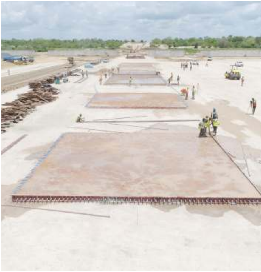
Mafundi wakiendelea na kazi ya ujenzi wa Bandari Kavu ya Kwala, wilayani Kibaha mkoani Pwani, jana. Bandari hiyo, itakuwa na uwezo wa kupokea kontena 3,000 kwa wakati mmoja kutoka Bandari ya Dar es Salaam, na kupunguza adha ya msongamano wa magari. PICHA: MARY GEOFFREY
