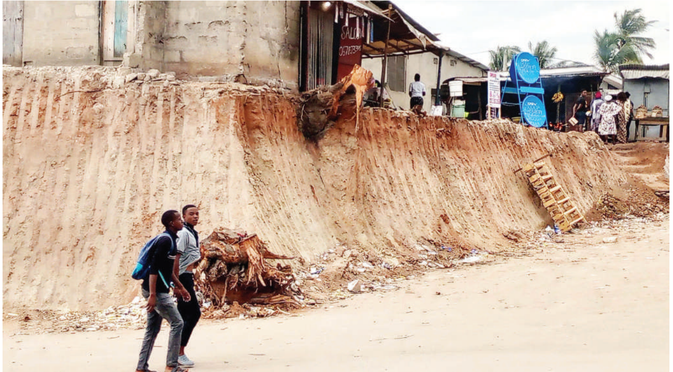
Nyumba zikiwa katika mazingira ya hatari baada ya udongo kuondolewa kwa ajili ya upanuzi wa barabara unaoendelea, eneo la Kimara Korogwe Dar es Salaam. Picha: SABATO KASIKA
