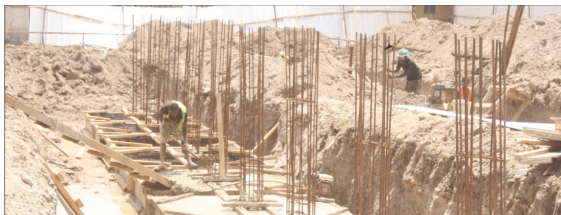
Mafundi wa Kampuni ya Pindoria Construction Ltd wakiendelea na ujenzi wa awamu ya pili wa madarasa kwenye Shule mpya ya Sekondari ya Liwiti iliyoko Manispaa ya Ilala jijini Dar es Salaam. PICHA: MPIGAPICHA WETU
