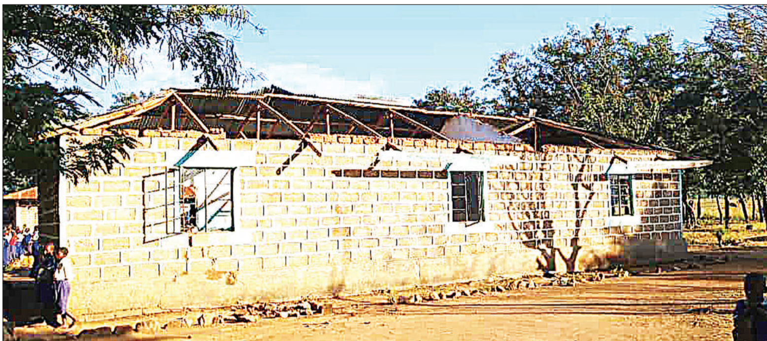
Moja ya majengo ya Shule ya Msingi Kamatondo, katika Kijiji cha Kamatondo, wilayani Musoma, mkoani Mara, likiwa limezuliwa mabati kutokana na mvua kubwa ya upepo iliyonyesha juzi na kuezua madarasa mawili na ofisi ya walimu. PICHA: MPI-GAPICHA WETU
