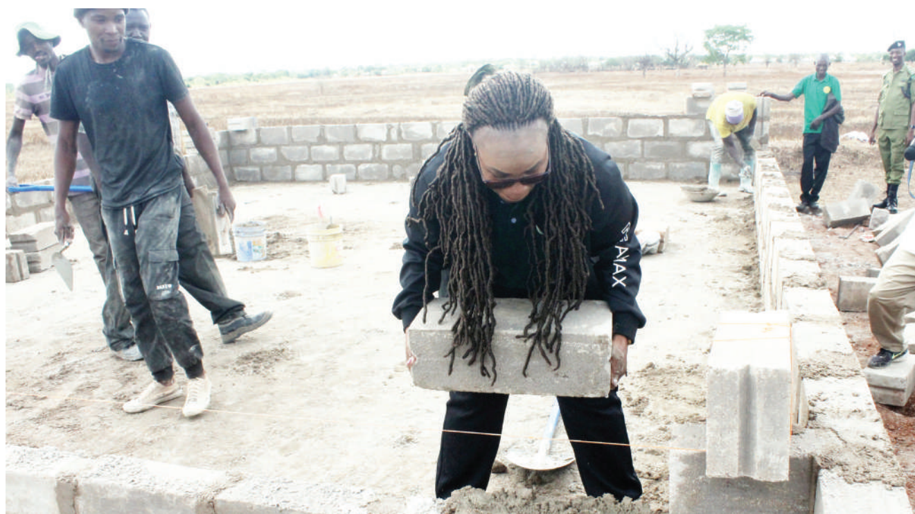
Mkuu wa Wilaya ya Shinyanga, Jasinta Mboneko, akishiriki ujenzi wa vyumba vya madarasa vitano katika shule mpya ya Sekondari Salawe, alipofanya ziara ya kukagua ujenzi wa shule hiyo juzi, ili mwakani ianze kufundisha wanafunzi wa kidato cha kwanza. PICHA: MARCO MADUHU
