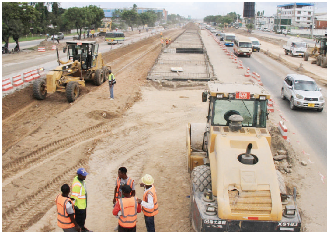
Muonekano wa ujenzi wa barabara ya mabasi ya mwendo kasi ukiendelea katika eneo la Vingunguti kwenda Gongo la Mboto jijini Dar es Salaam jana. PICHA: JUMANNE JUMA
