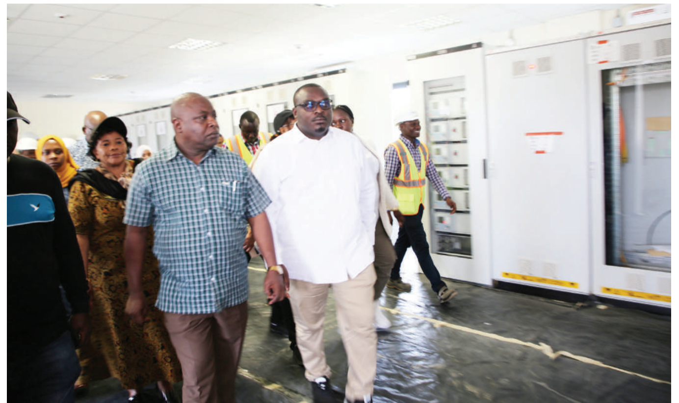
Wajumbe wa Kamati ya Kudumu ya Bunge ya Uwekezaji wa Mitaji ya Umma (PIC) wakikagua mitambo ya kupozea umeme wa reli ya mwendokasi (SGR) katika kituo cha Pugu Dar es Salaam jana. PICHA: OFISI YA BUNGE
