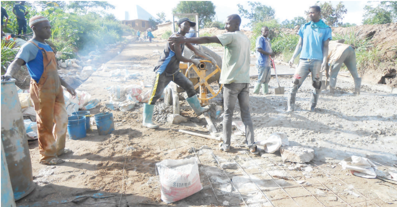
Mafundi wakiendelea na uwekaji zege kwenye eneo korofi la barabara ya makao makuu ya Wilaya ya Kilindi, Mkoa wa Tanga kuelekea Wilaya ya Gairo Mkoa wa Morogoro jana. PICHA: DEGE MASOLI
