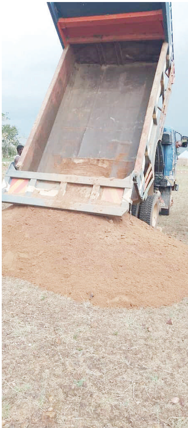
Lori likimwaga mchanga kwa ajili ya maandalizi ya ujenzi wa Shule ya Sekondari Mtiro mkoani Mara hivi karibuni, baada ya harambee ya uchangiaji wa ujenzi huo, ilioendeshwa na Mbunge wa Musoma Vijijini, Prof. Sospeter Muhongo. PICHA: MPIGAPICHA WETU
