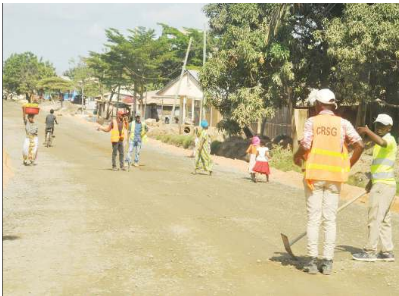
Mafundi wa Kampuni ya CRSK, wakiendelea na ujenzi wa barabara inayounganisha eneo la Kijitonyama na Sinza Uzuri, jijini Dar es Salaam jana. PICHA: JOHN BADI
