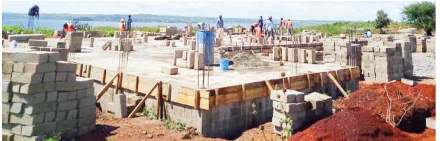
Ujenzi wa moja ya majengo ya hospitali ya wilaya ukiendelea. Picha: MARY GEOFREY.
