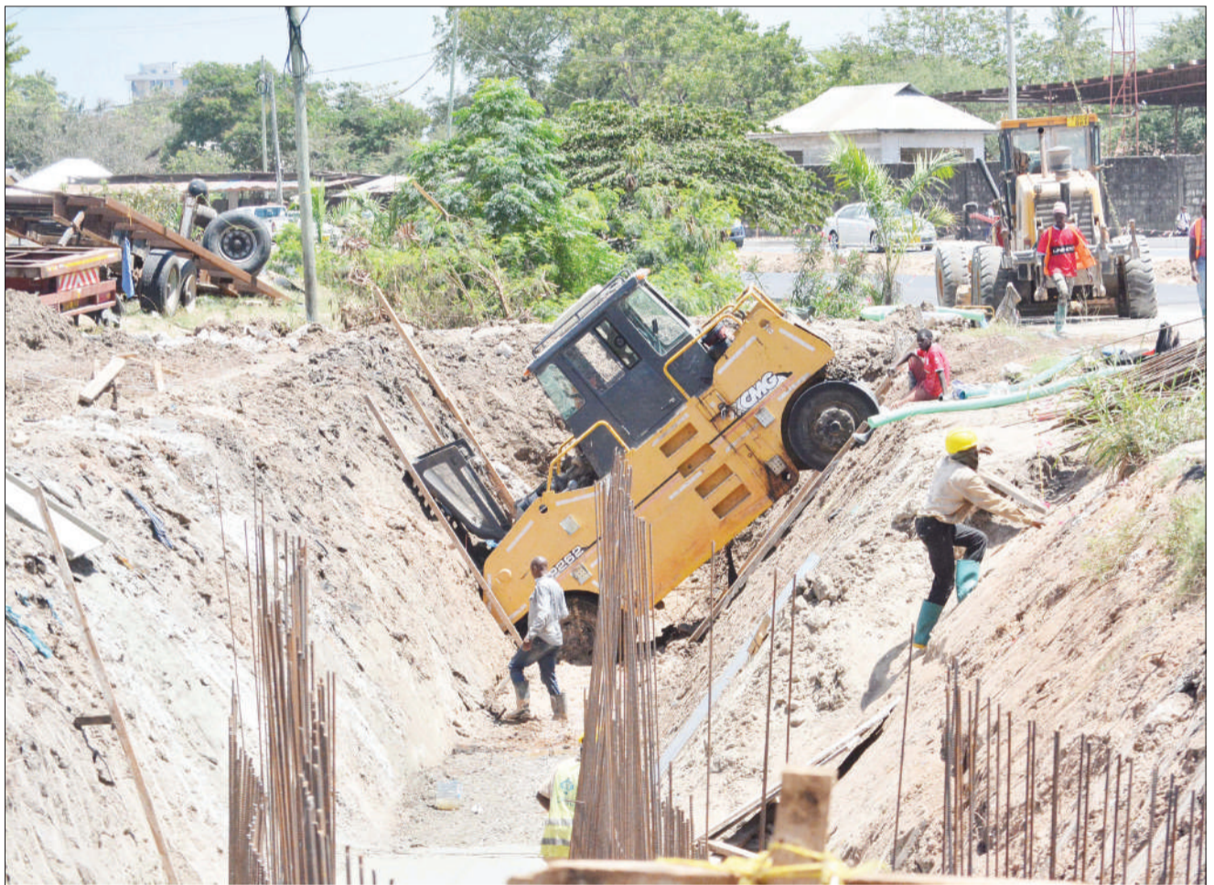
Gari maalum kwa ajili ya shughuli za ujenzi likiwa limetumbukia kwenye mtaro katika ujenzi wa barabara ya Shekilango, jijini Dar es Salaam jana. PICHA: MIRAJI MSALA
