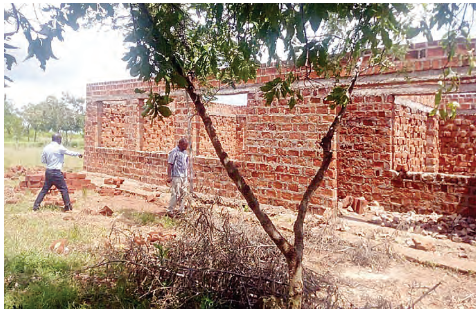
Diwani wa Kata ya Musanja, Musoma Vijijini, mkoani Mara, Ernest Mwira (kulia) na Mkuu wa Shule ya Sekondari Mabuimerafuru, Jonathan Lucas, wakikagua moja ya jengo la madarasa linalojengwa kwa nguvu za wananchi, shuleni hapo juzi, kwa ajili ya wanafunzi wa kidato cha kwanza. PICHA: MPIGAPICHA WETU
