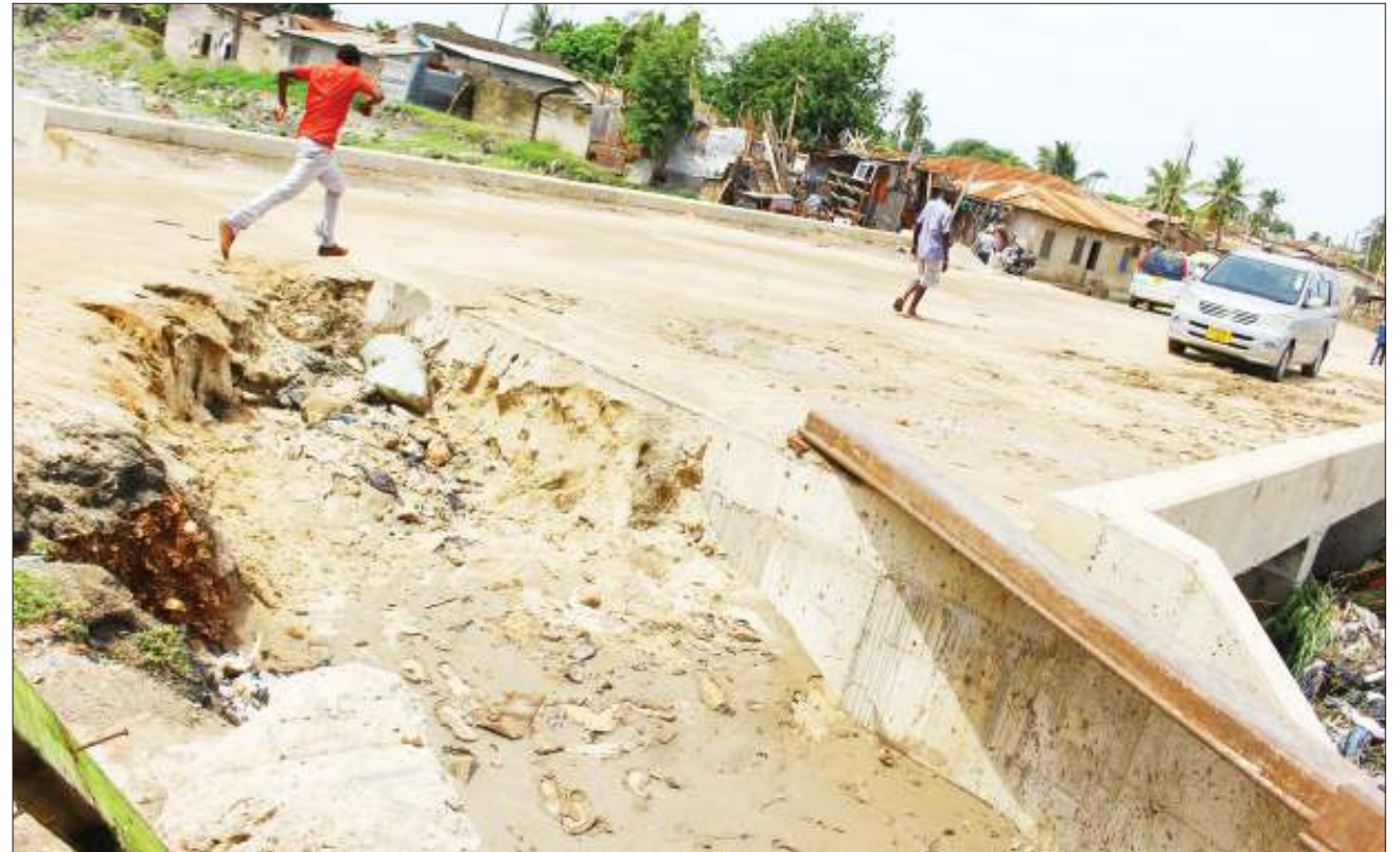
Wananchi wakipita kwenye daraja linalounganisha eneo la Mwananyamala kwa Manjunju na Tandale jijini Dar es Salaam jana, ambalo linahitaji ukarabati haraka kutokana na kuharibiwa na mvua zinazoendelea kunyesha jijini. PICHA: HALIMA KAMBI
