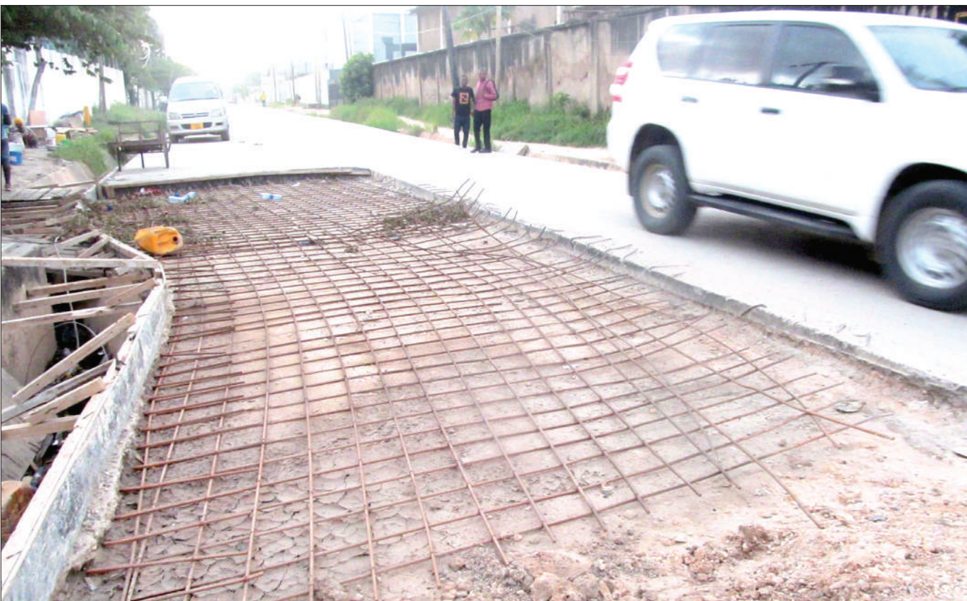
Sehemu ndogo ya Barabara ya Sewa, iliyokuwa ikijengwa kwa kiwango cha zege katika eneo la Viwandani, Mikocheni, jijini Dar es Salaam, ikiwa haijamalizwa kujengwa kwa zaidi ya mwezi mmoja sasa na kusababisha usumbufu kwa watumiaji wa barabara hiyo. PICHA: SABATO KASIKA
