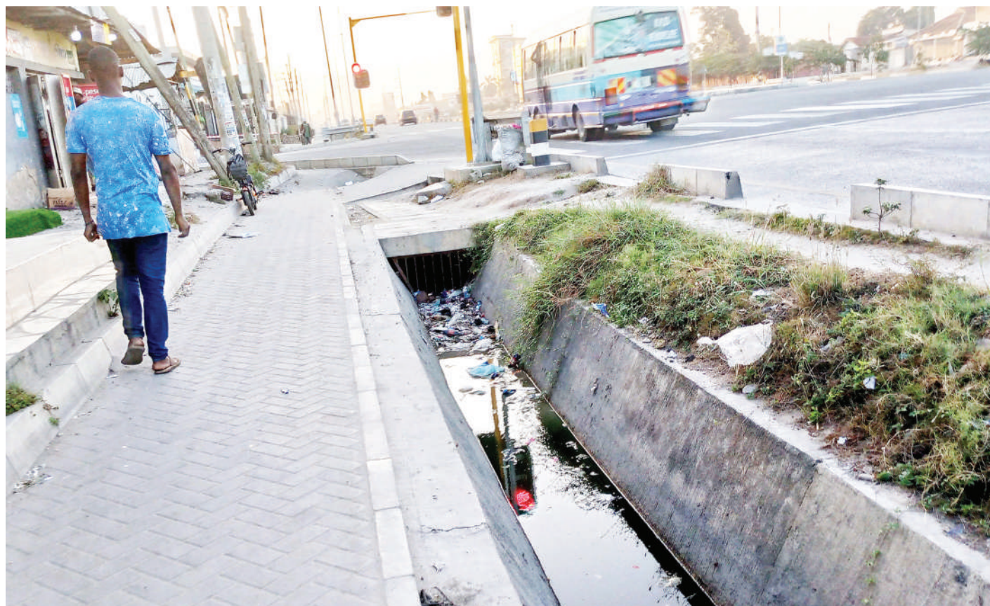
Maji machafu yakiwa yametuama kwenye mfereji wa maji ya mvua kando ya Barabara ya Bagamoyo, eneo la Mwenge, mkoani Dar es Salaam jana na kusababisha usumbufu kutokana na harufu mbaya. Baadhi ya wafanyabiashara wa eneo hilo, walidai kuwa maji hayo humwagwa na mama lishe. PICHA: SABATO KASIKA
